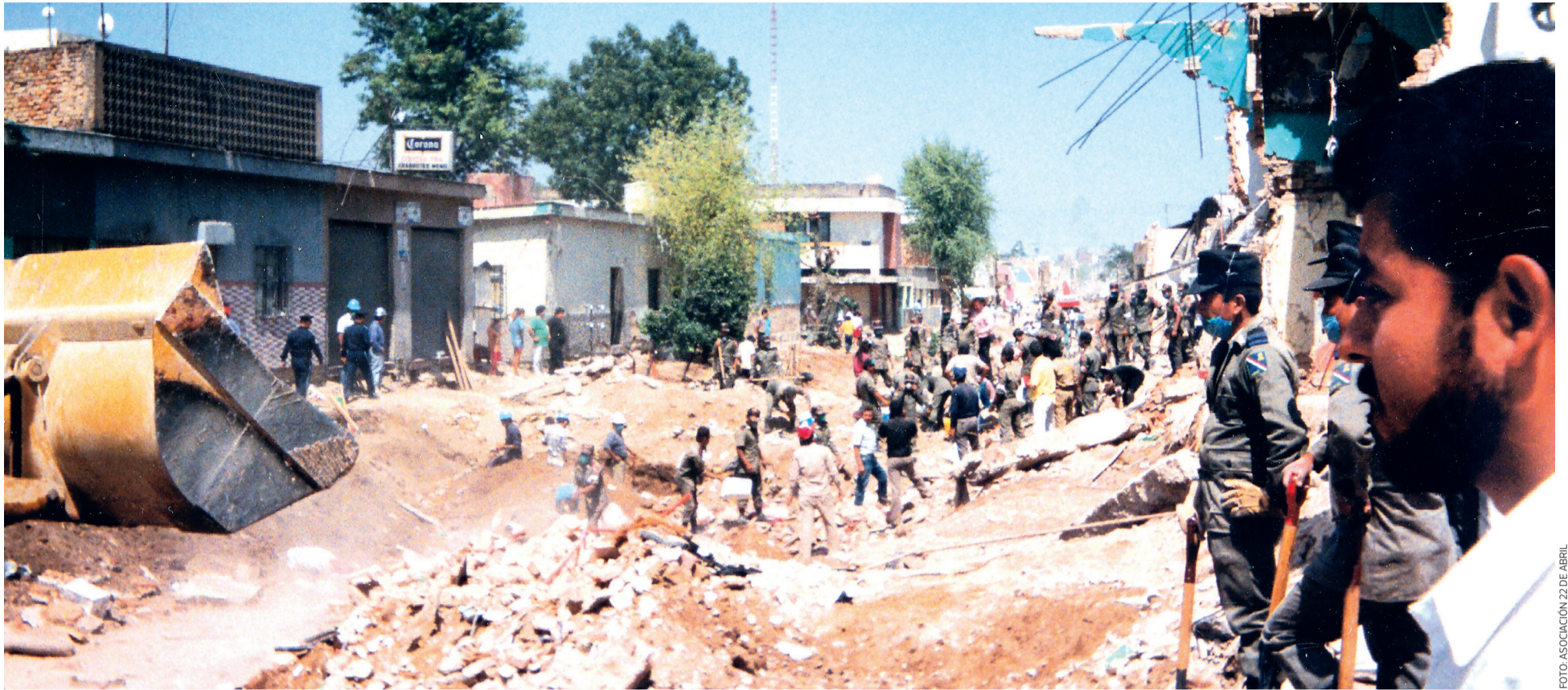
Lo sucedido en 1992 comprobó que la ciudad puede recuperarse y que el desastre se supera en comunidad.
